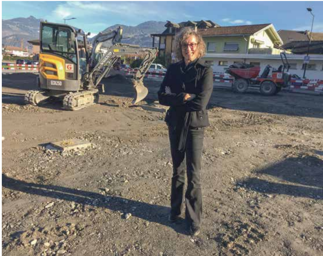
Selon Sylviane Coquoz, les travaux sur la place Tarnaiaie seront terminés au printemps. | K. Di Matteo
