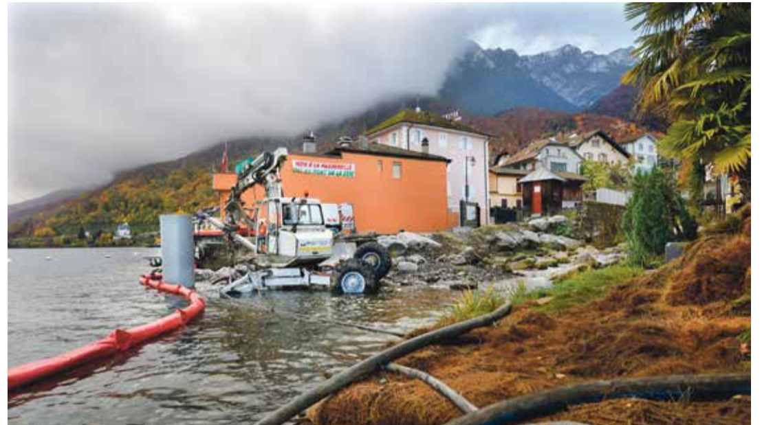
En 2018, travaux préparatoires pour l'érection de la passerelle entre les deux rives. | Archives - 24 heures
