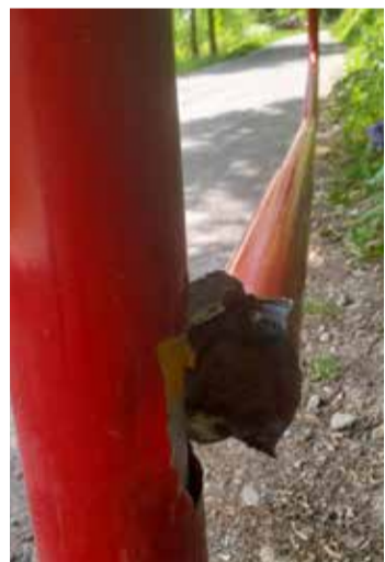
La barrière a été vandalisée deux fois déjà.
