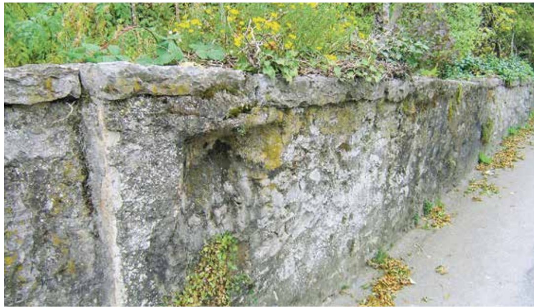
Une partie du mur d'enceinte du château de Rennaz pourrait s'écrouler. Une solution pacifique entre autorités et propriétaire se dessine après des années de guerre.
